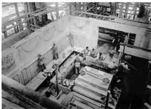
30 Marzo 1938. Il re visita lo stato dei lavori in corso all'Ara Pacis di Augusto
