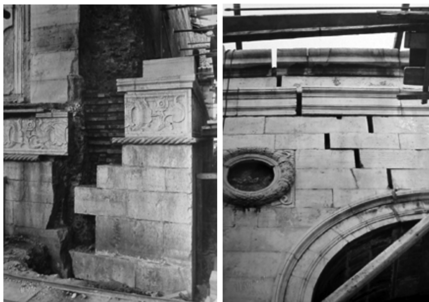
Dislivelli e lesioni alla facciata e al fianco del tempio Malatestiano
